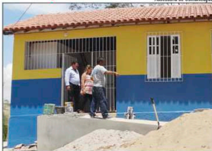
» Prefeito Robertino, o Tininho visitando as obras da Escola de Lagoa Dantas
